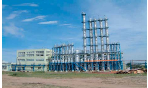
Í lok árs 2003 hófst bygging 10.000 tonna tilraunaverksmiðju í Changchun í Ilinhéraði í Kína. Byggingunni er að mestu lokið og nú er unnið að því að koma verksmiðjunni í gang.
