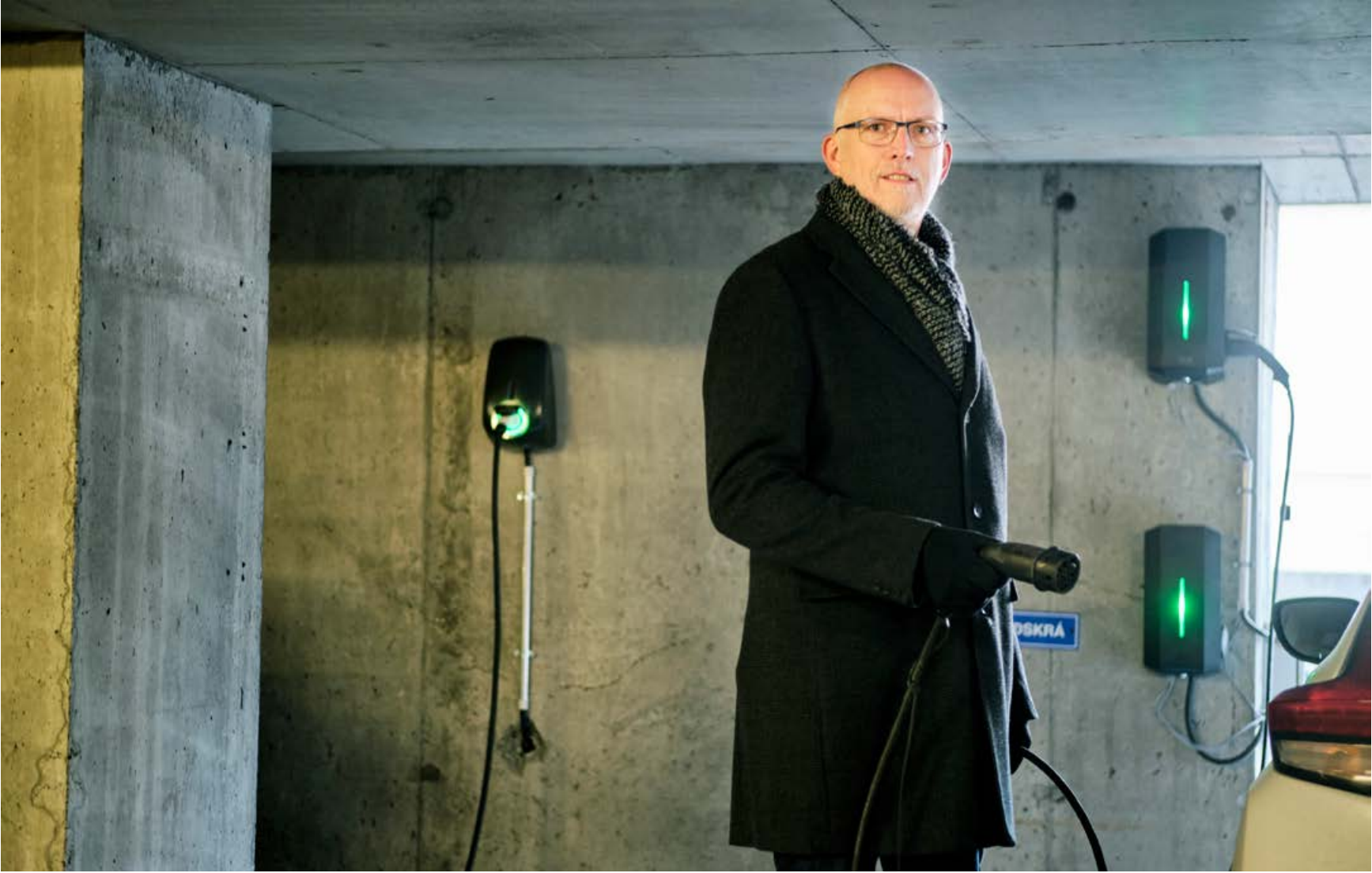
Kristján segir skynsamlegt að hugsa til framtíðar þegar kemur að uppsetningu hleðslustöðva þvi rafbílaeign eykst stöðugt og þá er bæði minna rask og hagstæðara að fá rafverktaka til að setja upp fleiri en eina hleðslustöð í einu. FRÉTTABLAÐIÐ/ ANTON BRINK
