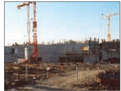
Höfnstöðvar Orkuveitu Reykjavíkur við Réttarháls
